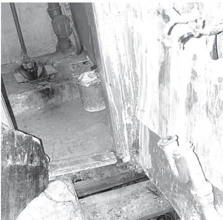
Унитаз в подъезде №1 дома 83 на 4а мкр. почти провалился.
