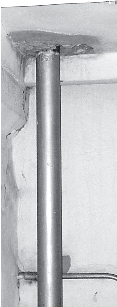
Результат “взрыва” - щели в стенах квартир и трещины около труб в подъезде.
